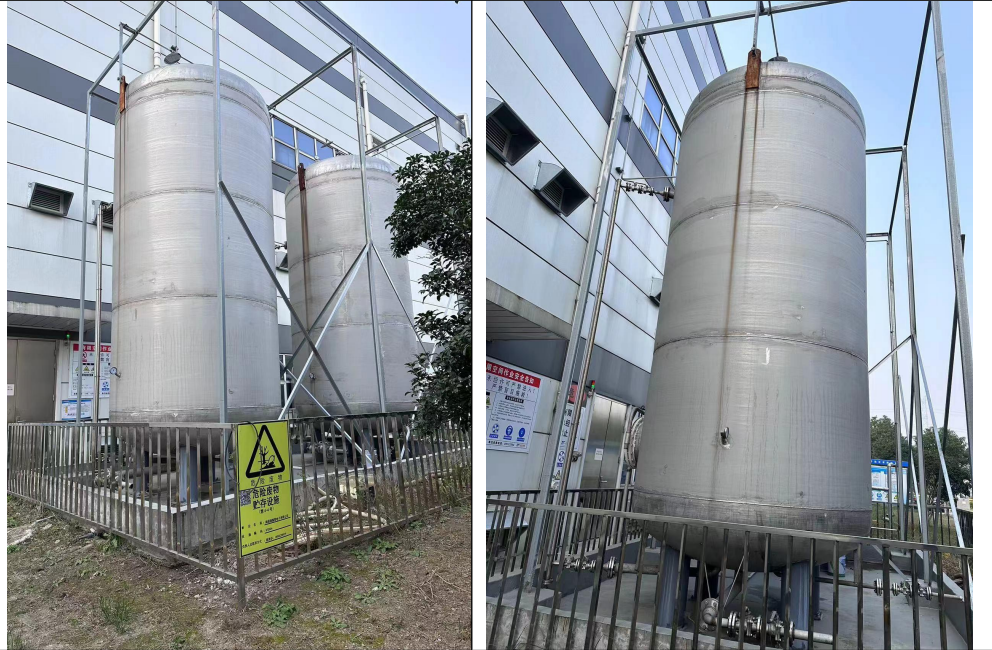
有机废液储罐
