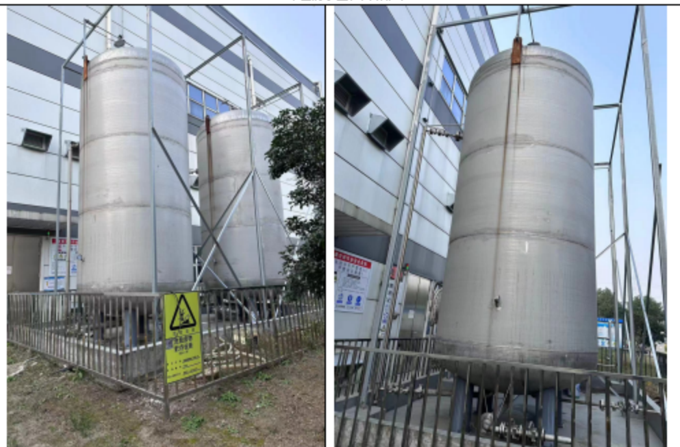
有机废液储罐
